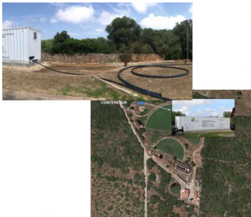
Figura 3. Planta piloto de inyección de agua regenerada a partir del terciario de una EDAR urbana en Menorca (UTE Northline-Amphos 21(2024) para la DGRH del Gobierno Balear).
